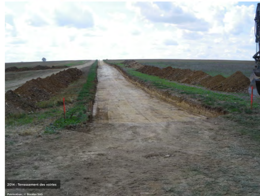
Figure 90. Ci-contre, exemples de travaux réalisés pour l'enfouissement des réseaux et les pistes d'accès
